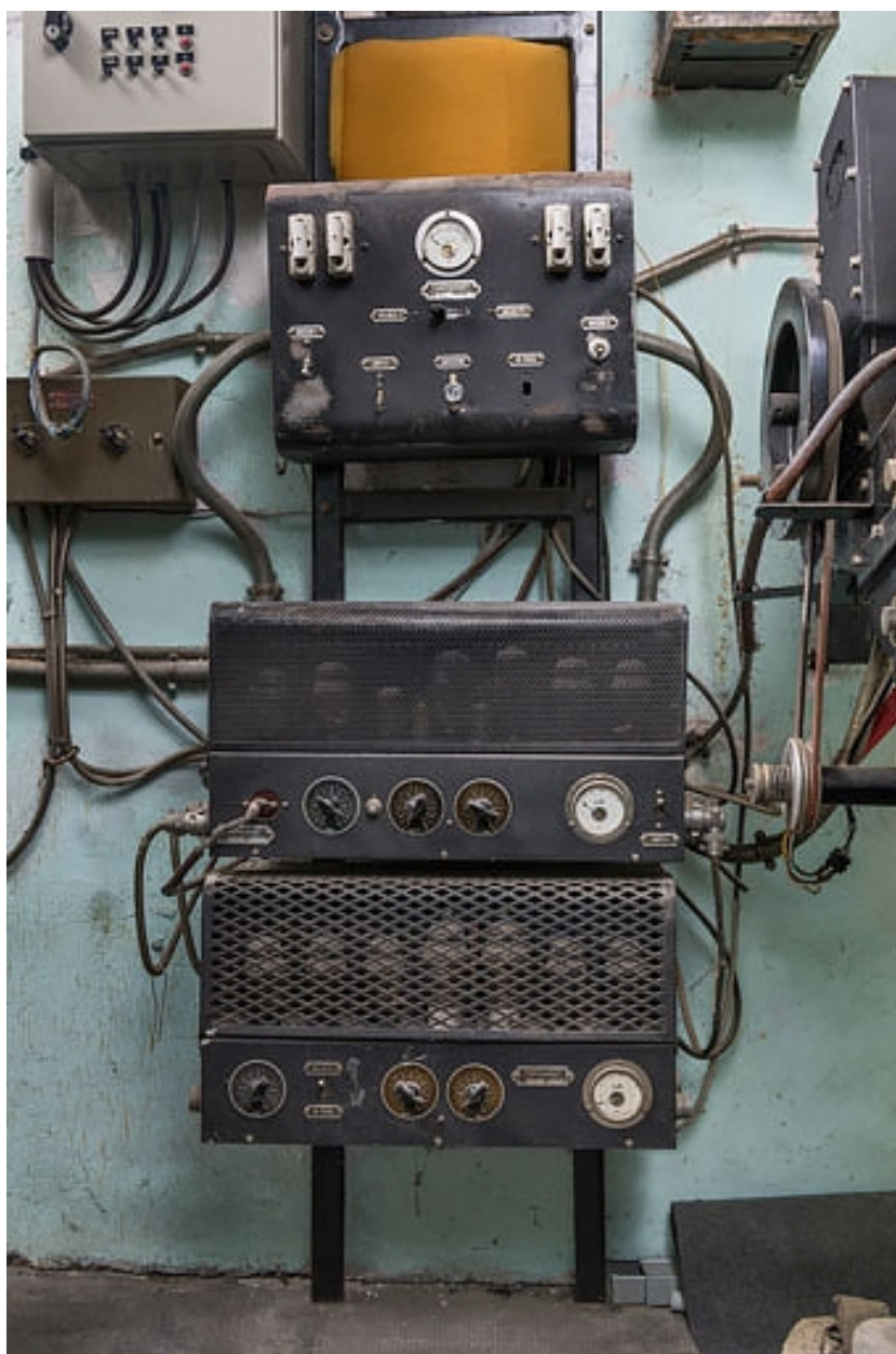
Installation de sonorisation : amplificateurs.
