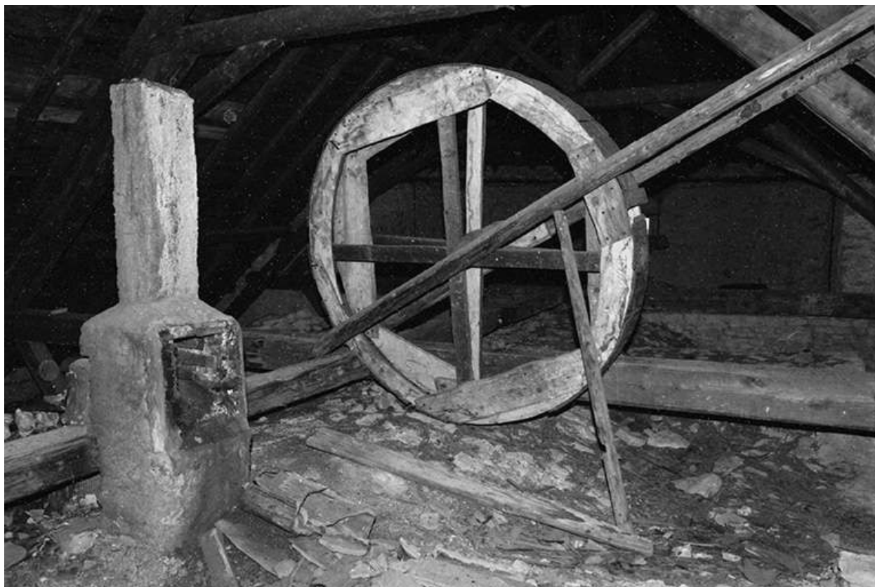
Combles : l'un des treuils.
