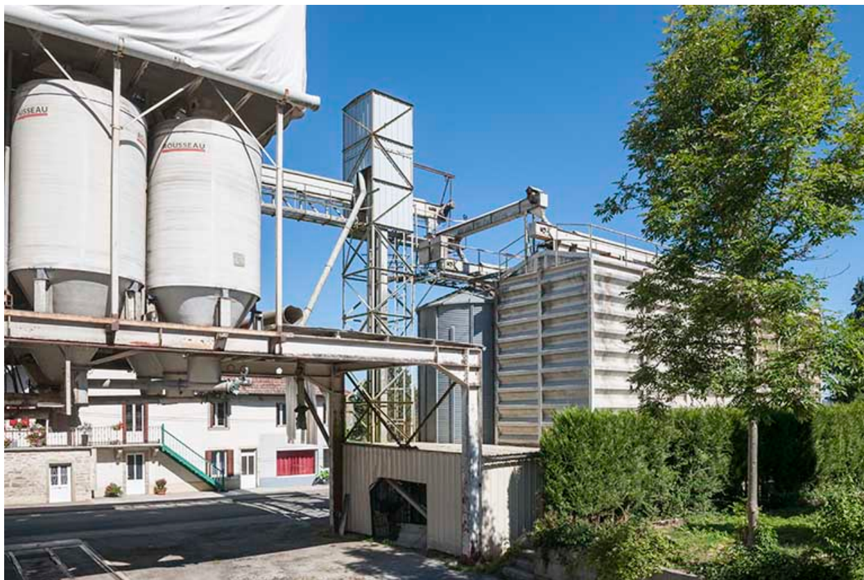
Silos et installations de chargement/déchargement.
