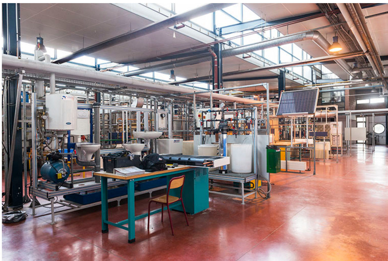
Vue intérieure des ateliers du pôle énergie.
