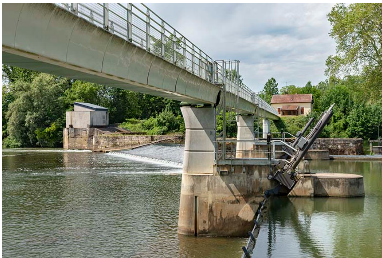
Vue de détail sur les clapets.
