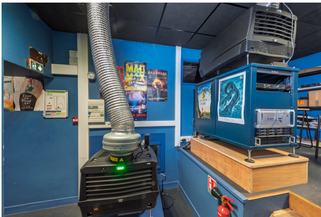
Cabine de projection : projecteurs Barco DP2K12C.
