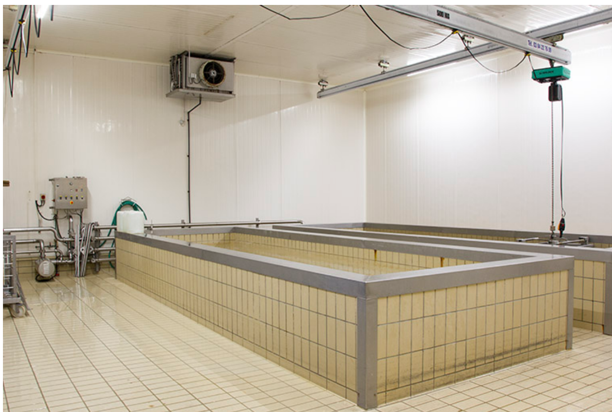
Atelier de saumurage : vue d'ensemble.
