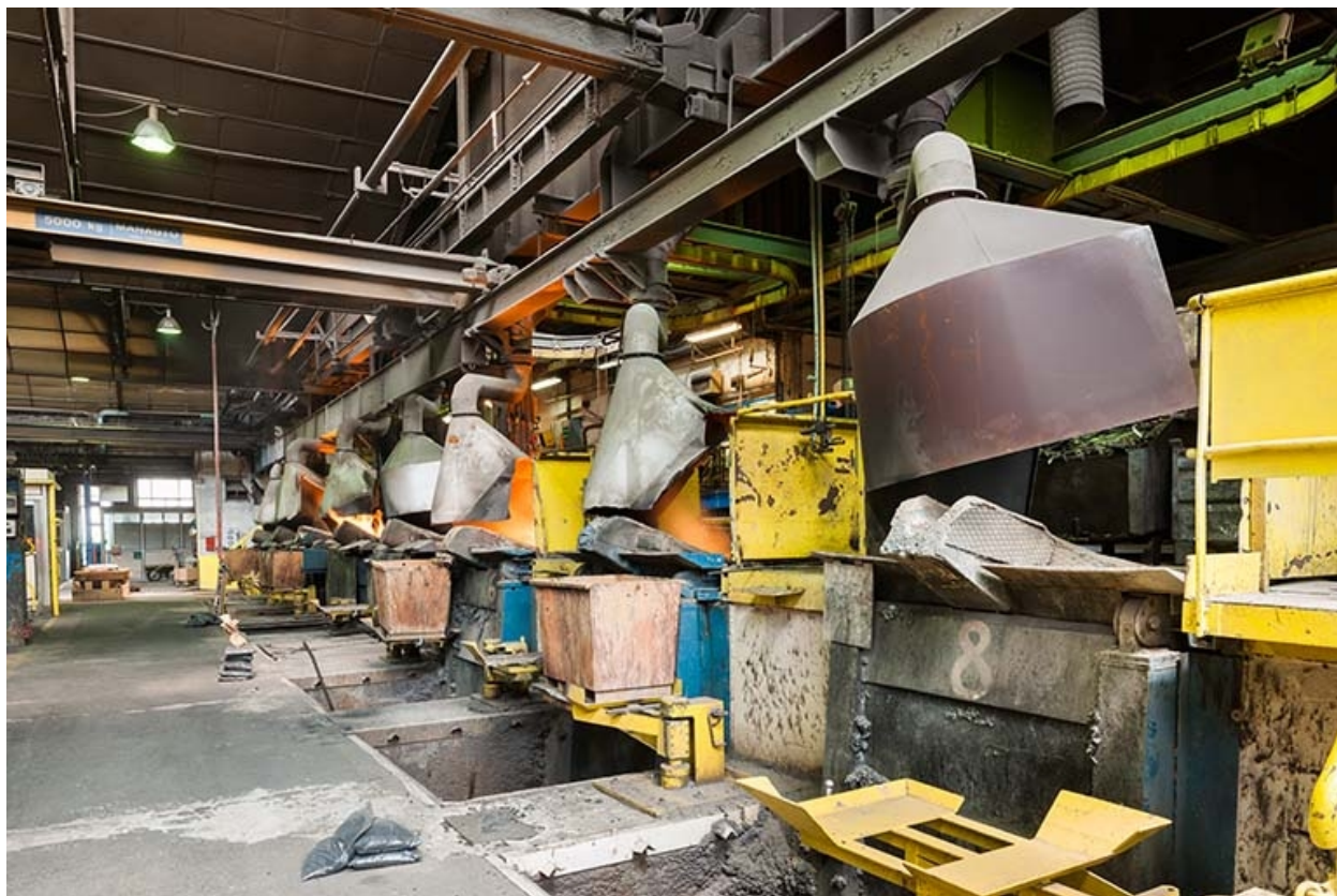
Batterie de fours à induction (2).
