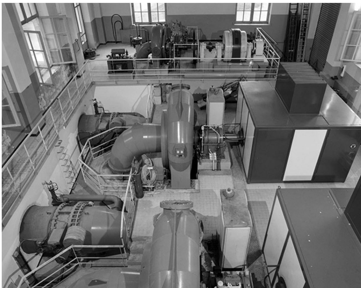
Intérieur de la centrale.
