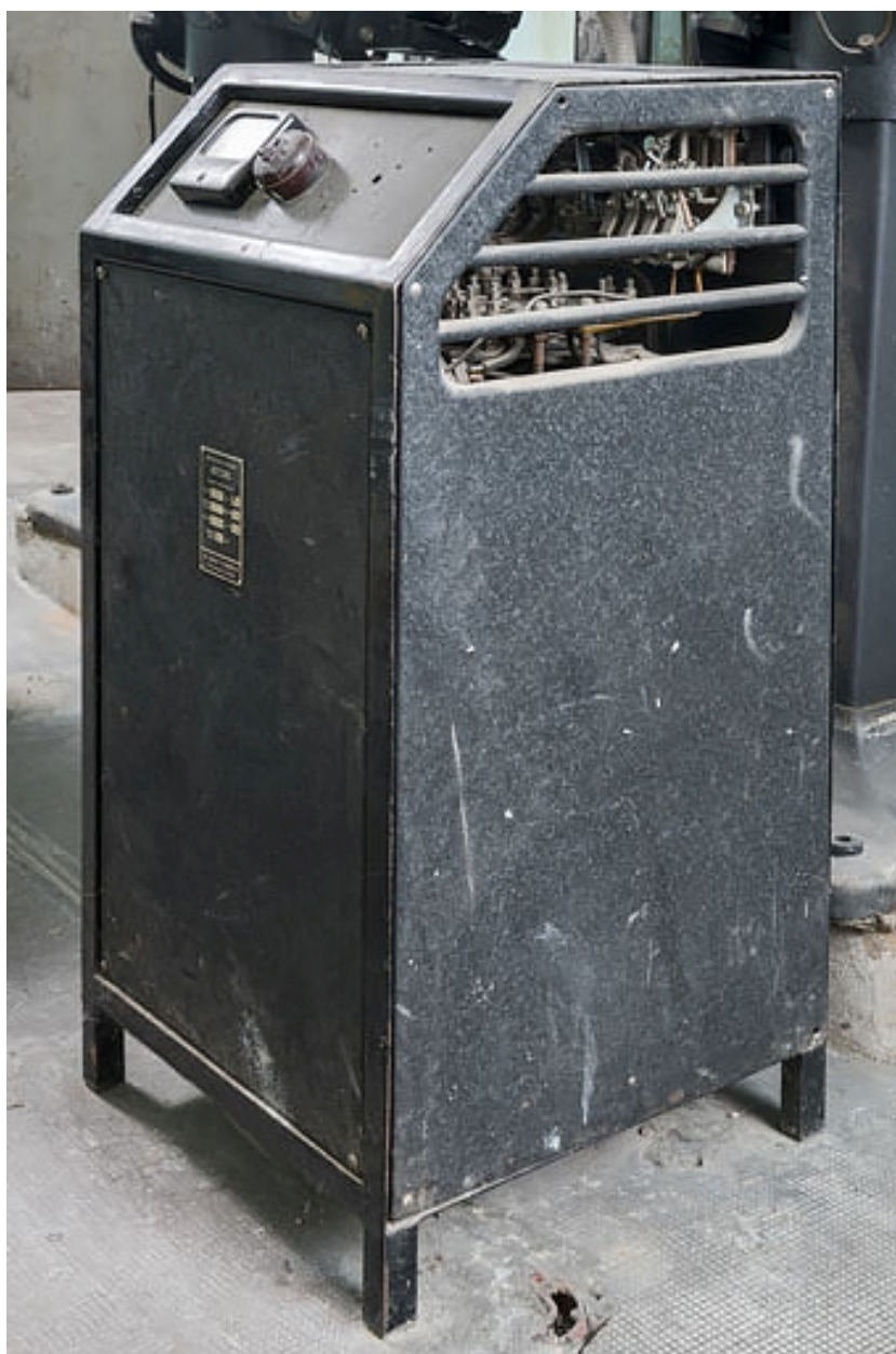
Redresseur Rectarc désaffecté.
