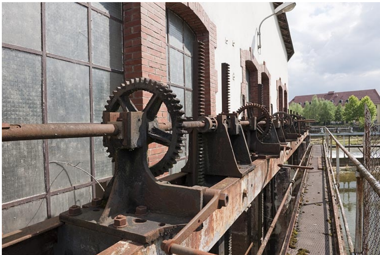
Détail du vannage de prise d'eau.
