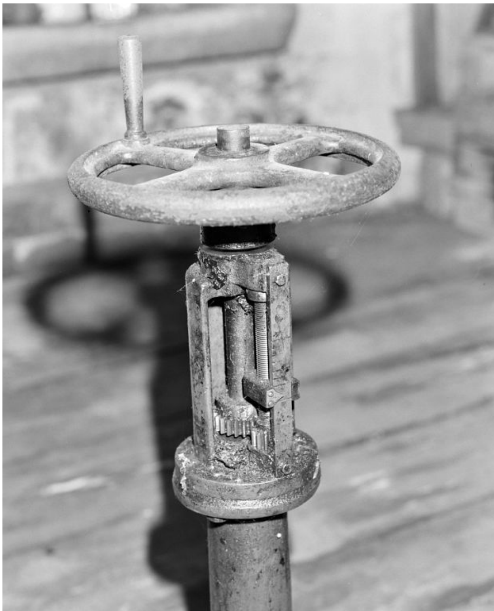
Rez-de-chaussée. Commande d'ouverture de vanne, détail.
