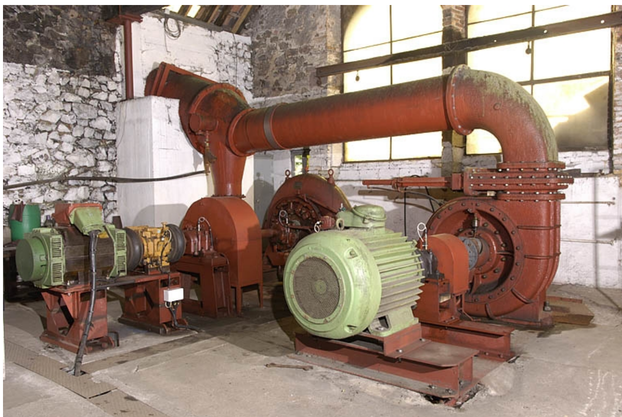
Forge du Haut. Vue d'ensemble des turbines.
