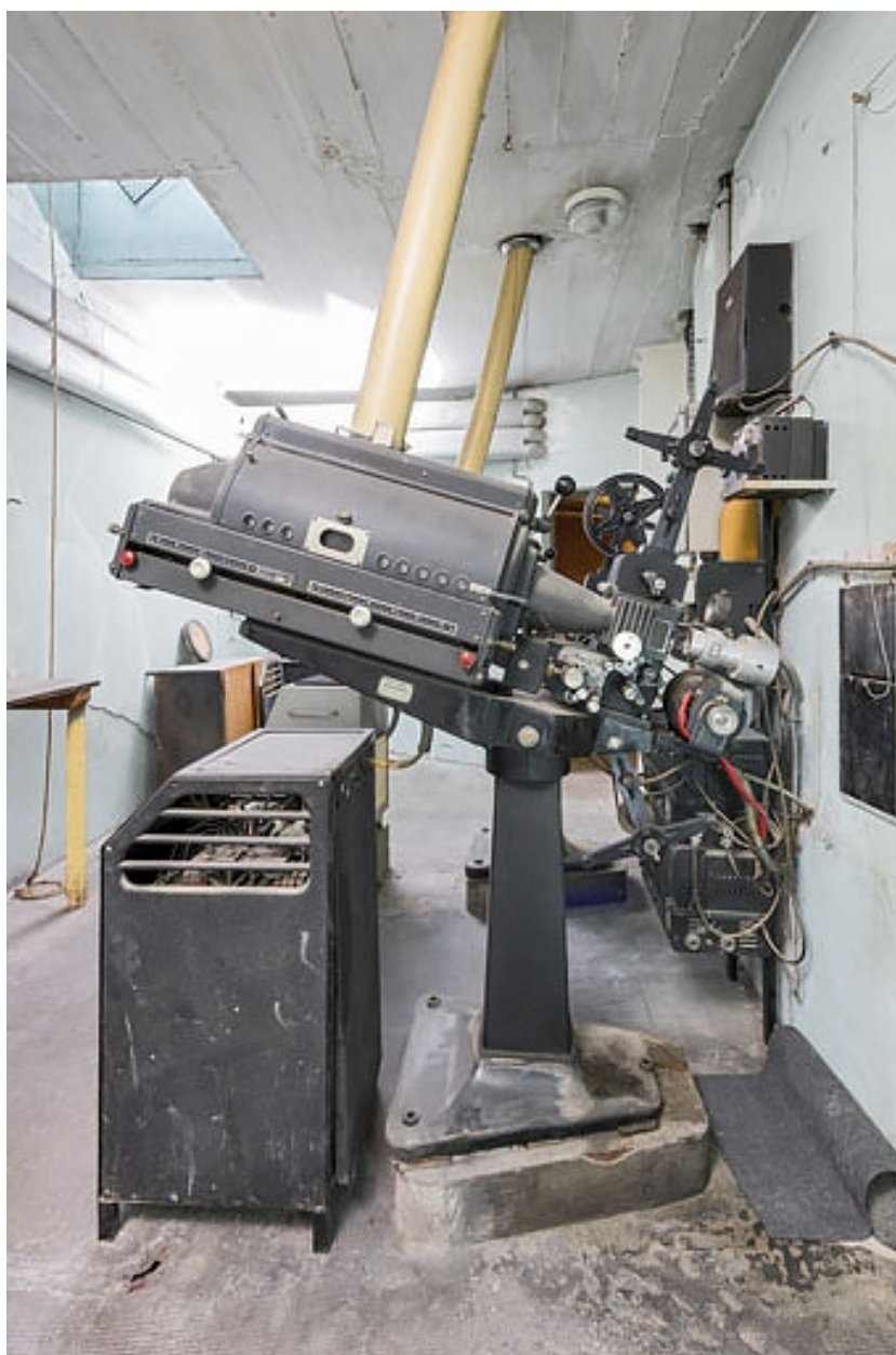
Projecteur côté cour et son redresseur.
