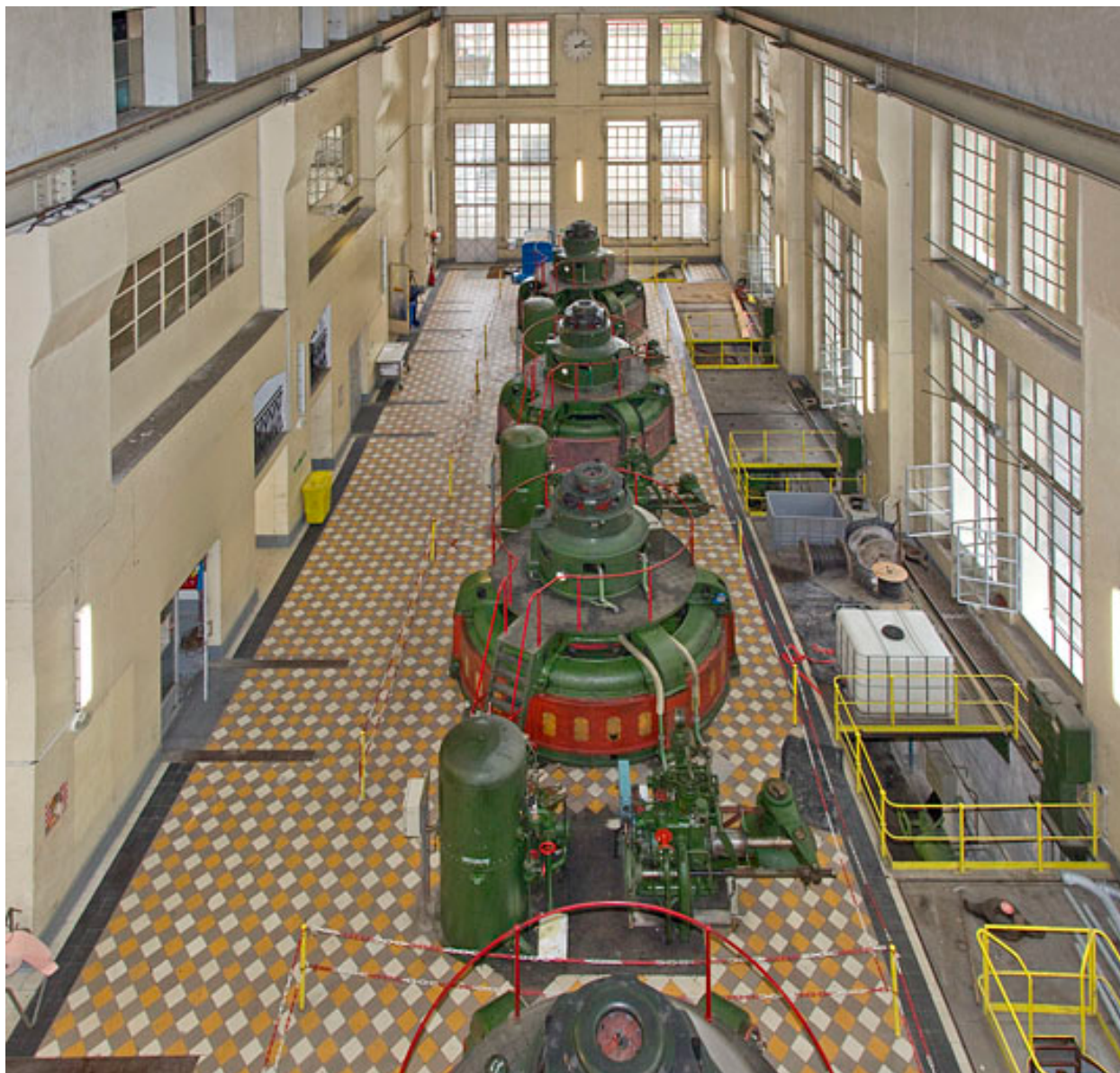
Centrale hydroélectrique de Liebvillers : intérieur.
