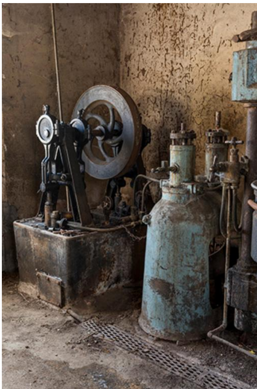
Machines du rez-de-chaussée: pompe hydraulique et régulateur
