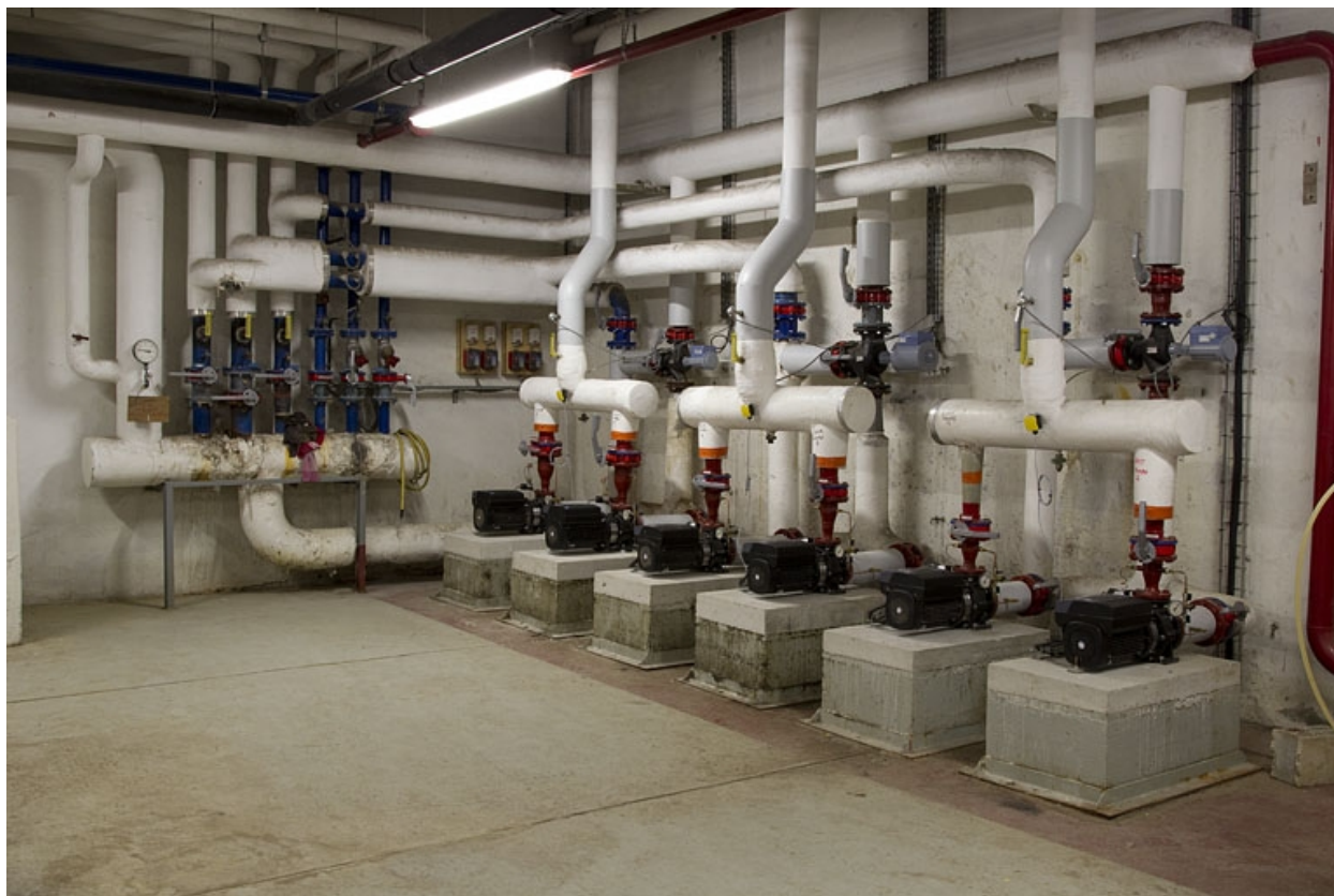
Bâtiment de l'internat ouest, chaufferie : les pompes.
