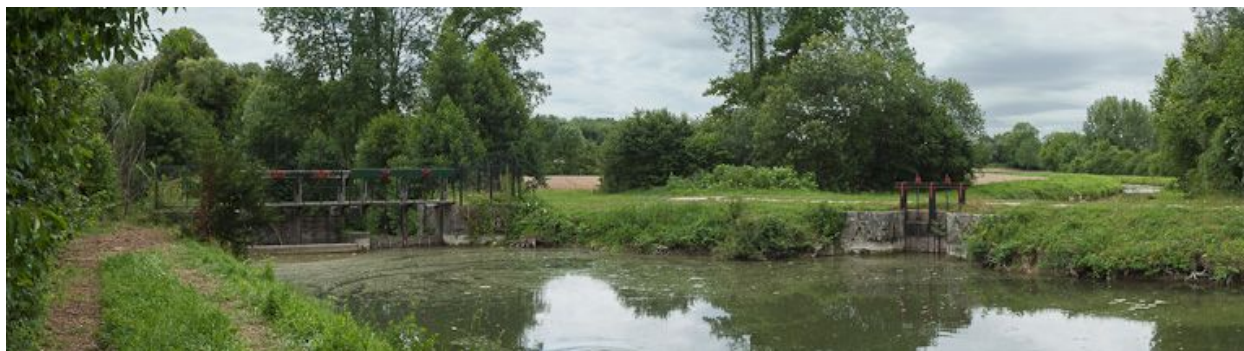
Vue des vannes de prise d'eau.
