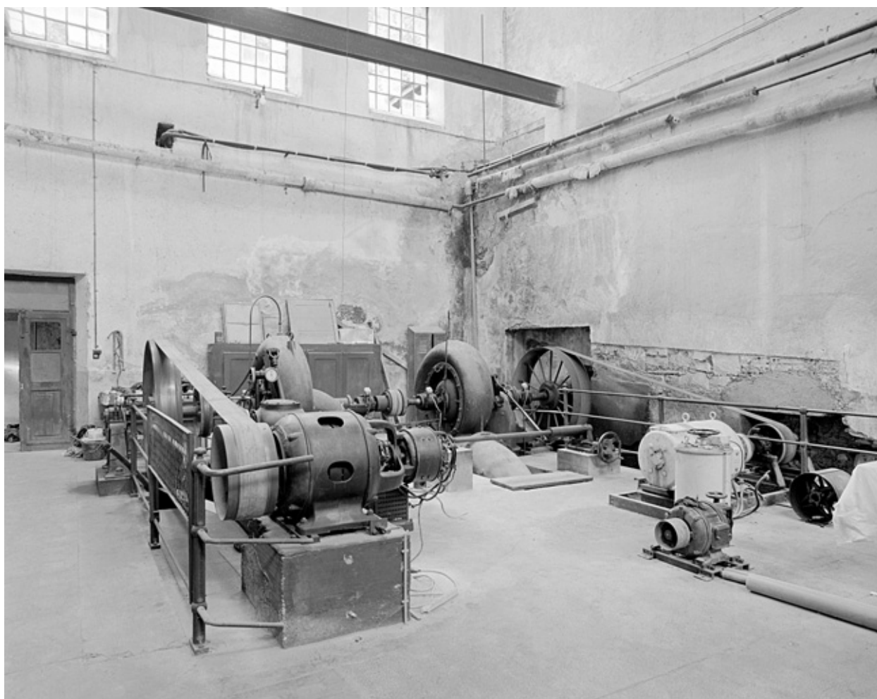
Turbines et alternateurs.
