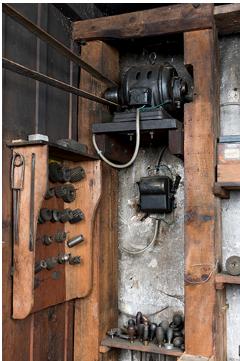
Vue d'ensemble du moteur électrique.
