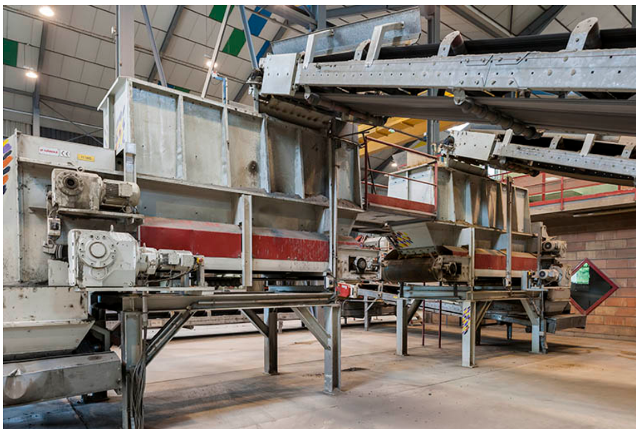
Unité de préparation des terres. Doseurs-tampon.
