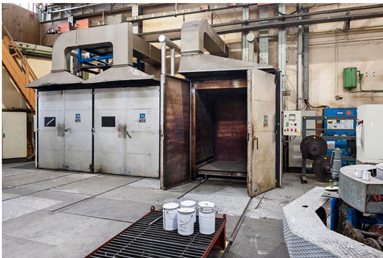
Fours de l'atelier d'imprégnation.
