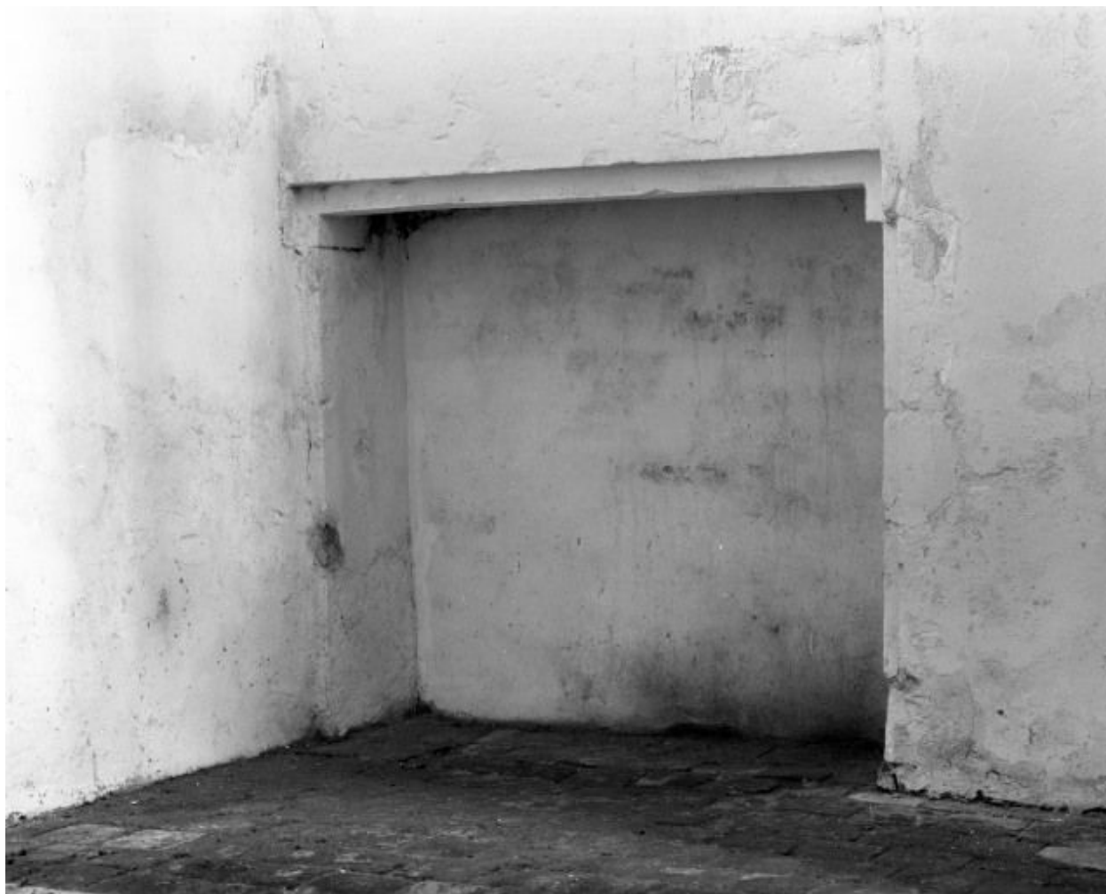
Chapelle seigneuriale, mur gauche, cheminée
