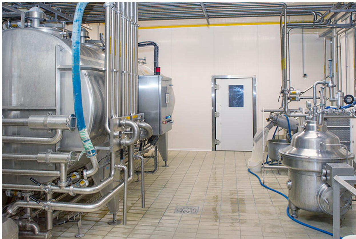
Salle de la station de lavage CIP.
