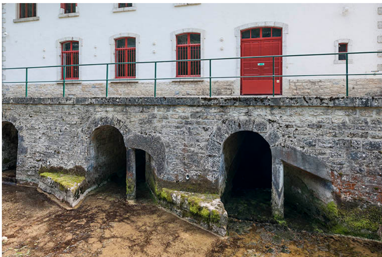
Conduits d'évacuation des groupes turbo-alternateurs.
