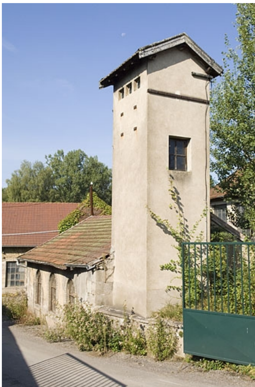
Le transformateur électrique depuis l'entrée.
