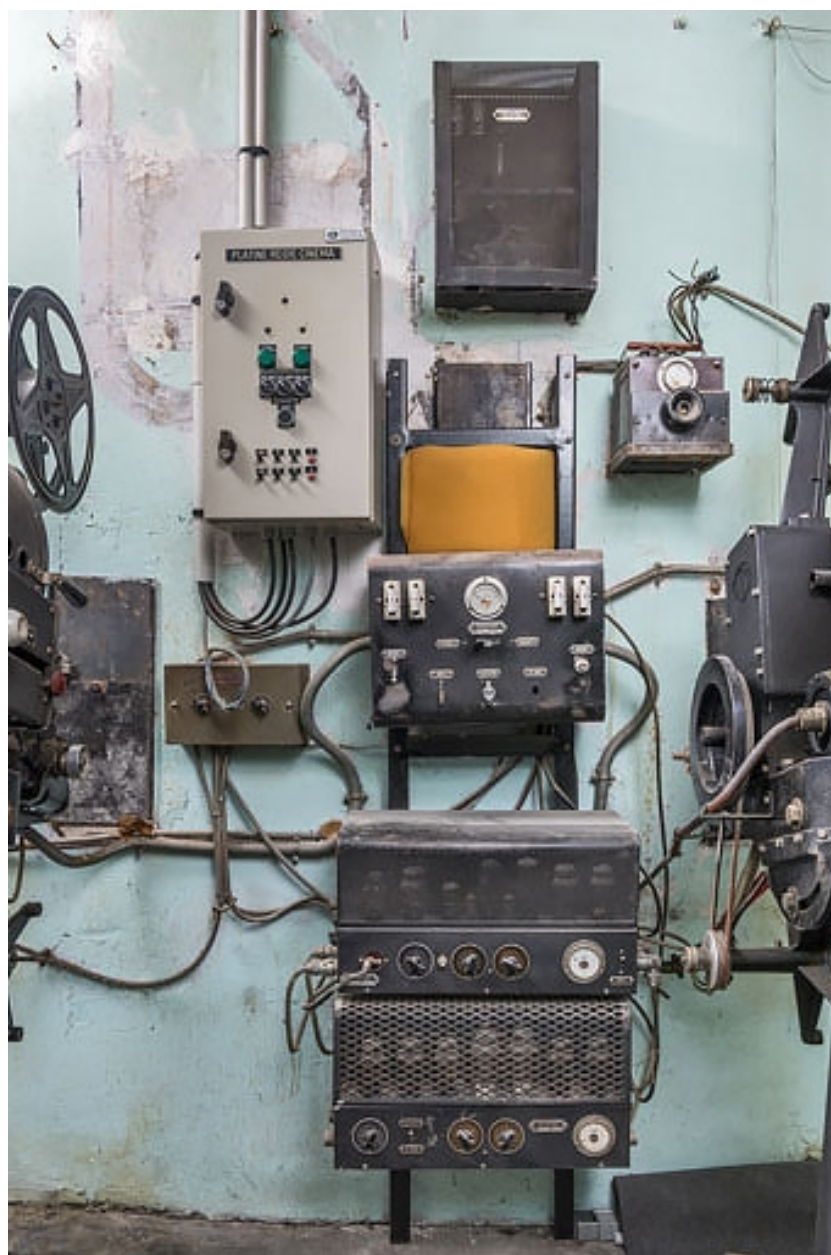
Installation de sonorisation.
