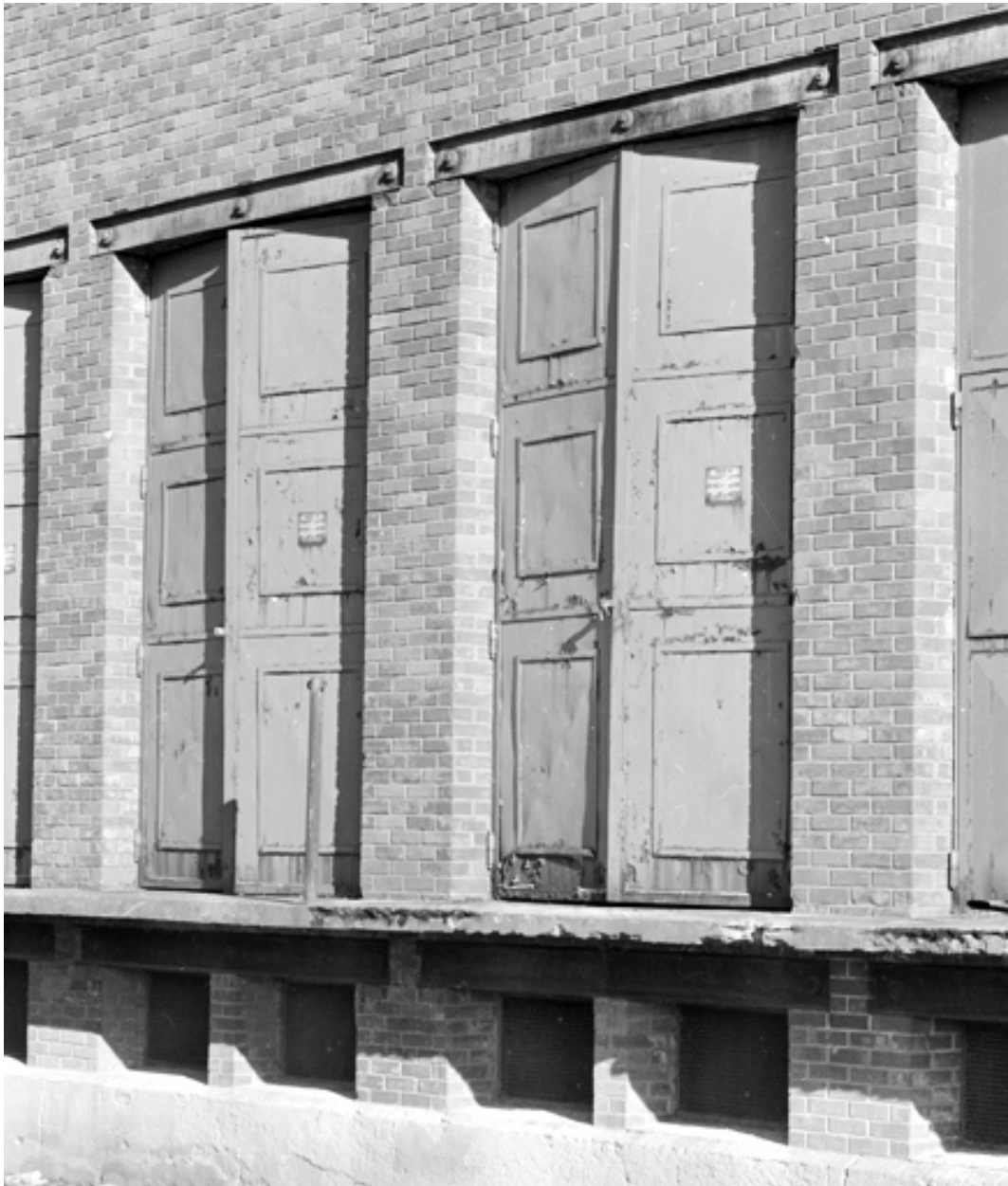
Transformateur : détail des portes métalliques.
