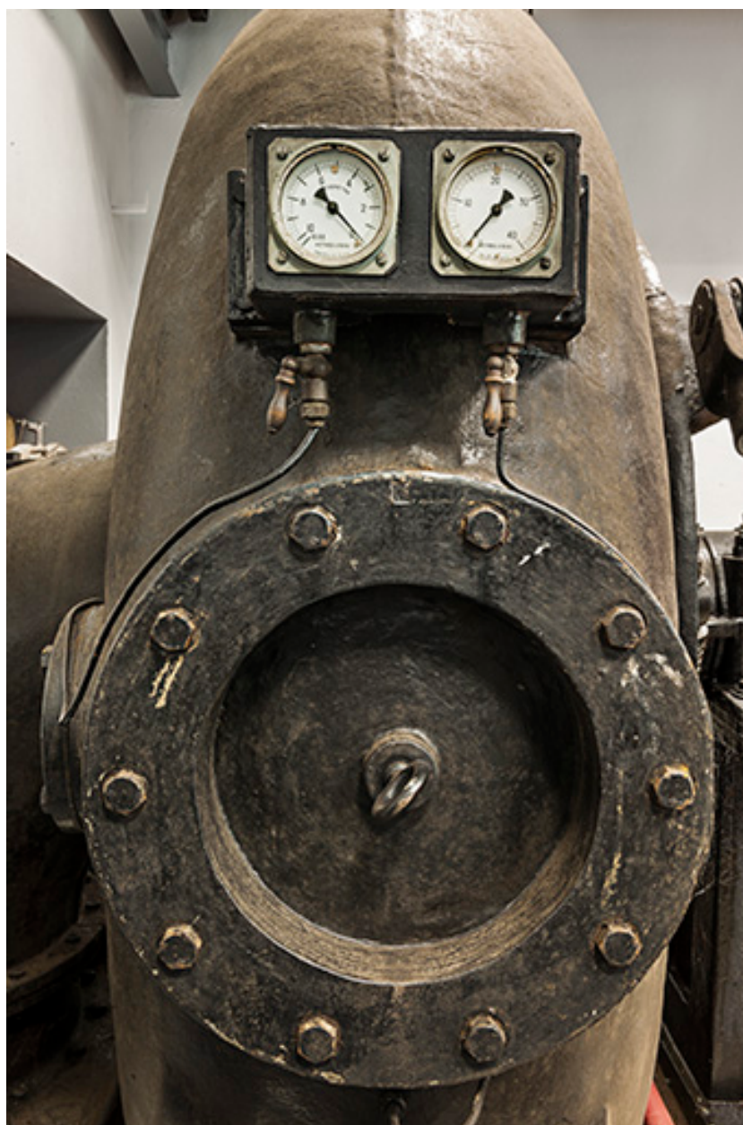
Bâche de la turbine du groupe 4.
