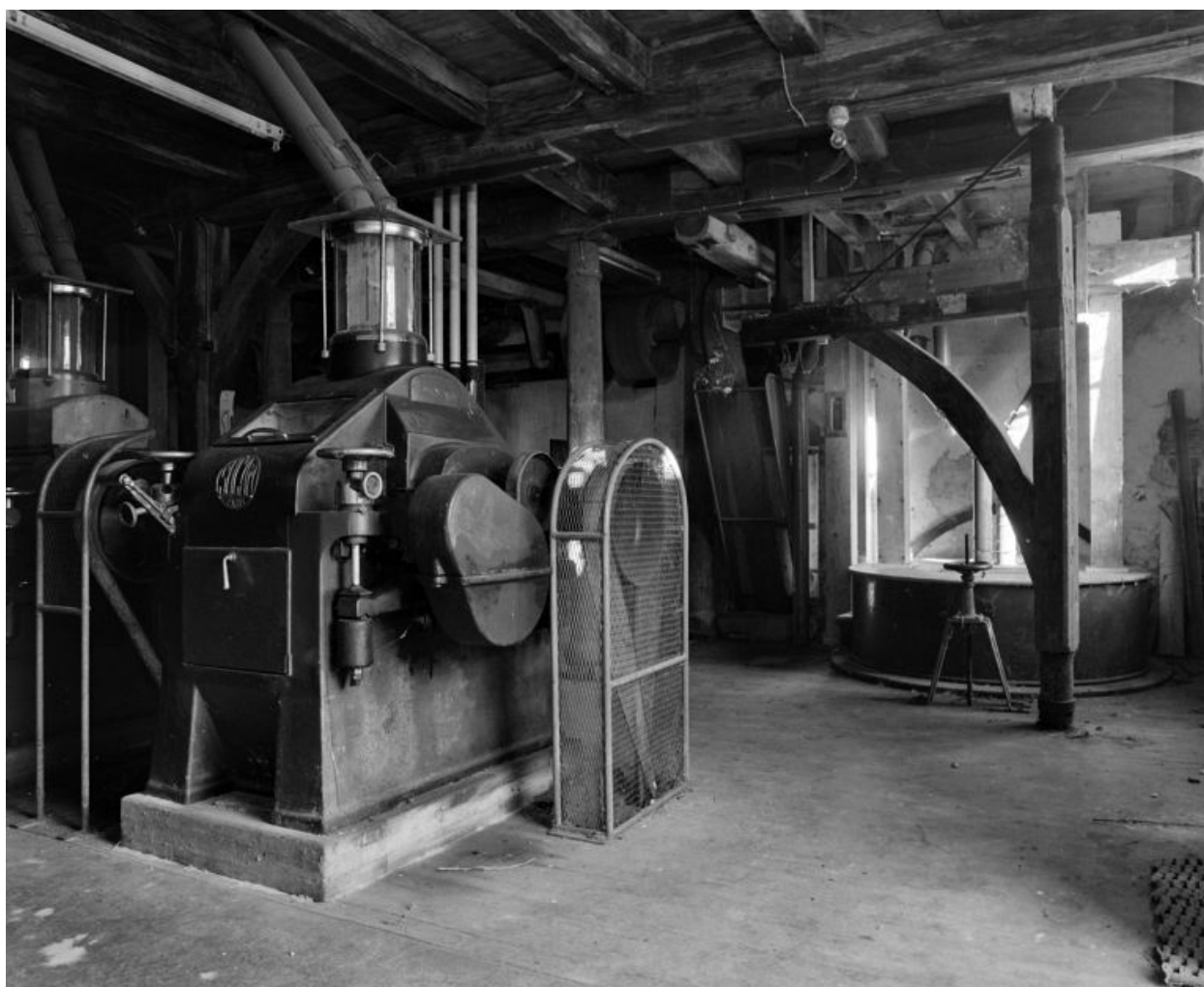
Rez-de-chaussée. Broyeur (marque Socam, Paris).
