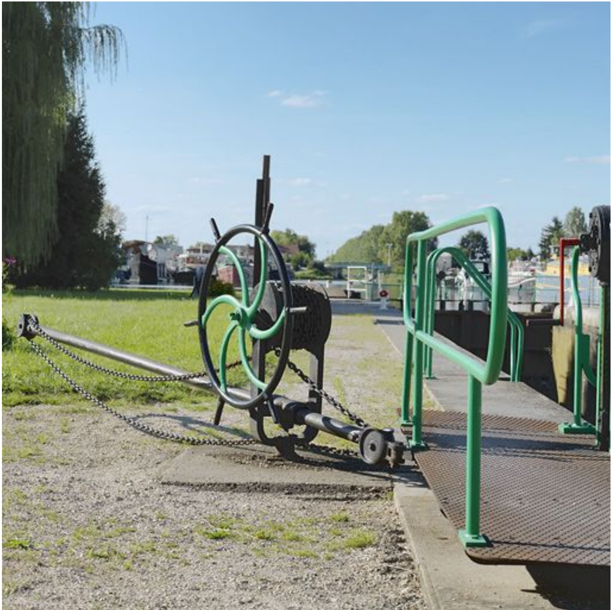
Détail du mécanisme des portes du sas.
