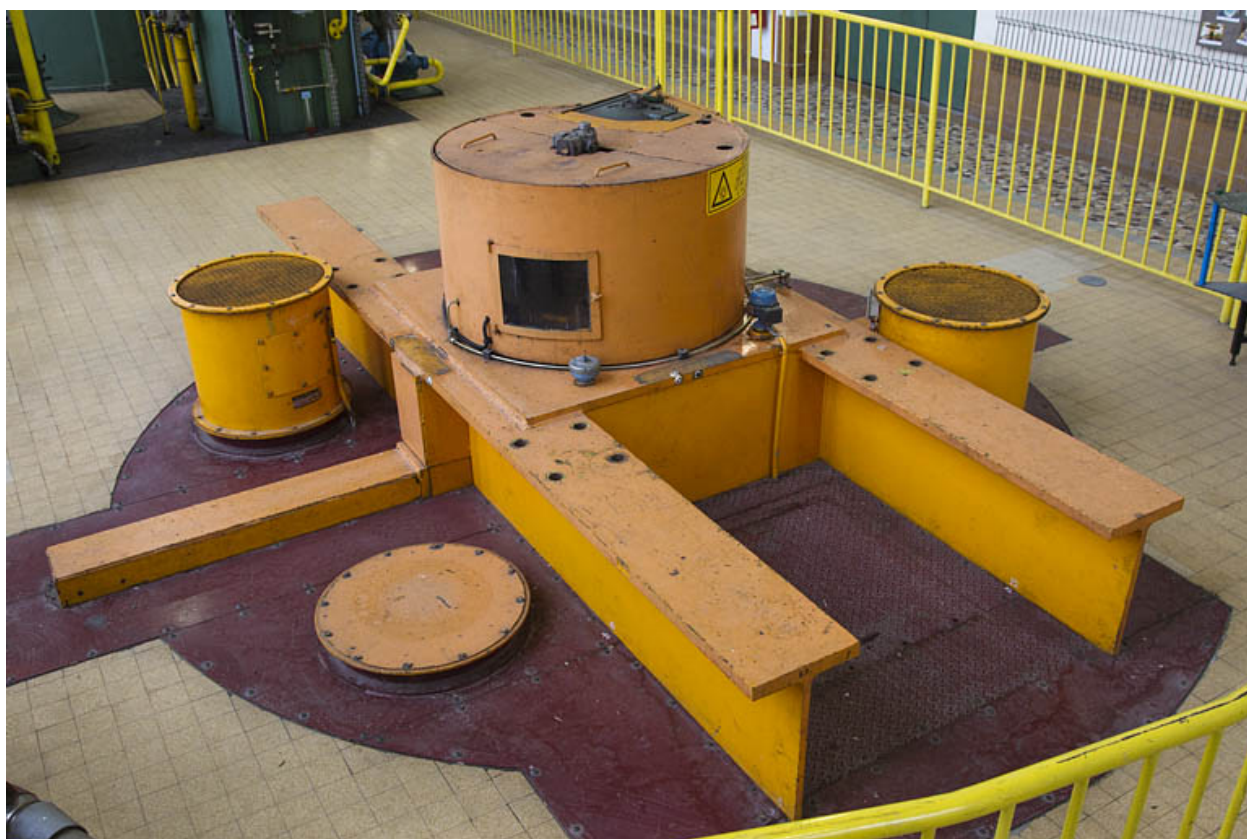
Partie supérieure de la turbine n°3.
