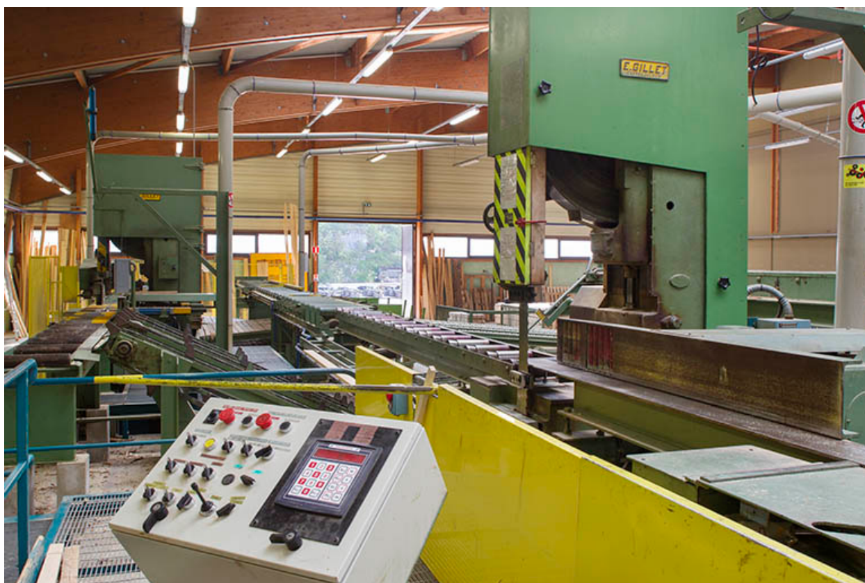
Scierie : poste de commande automatisé.
