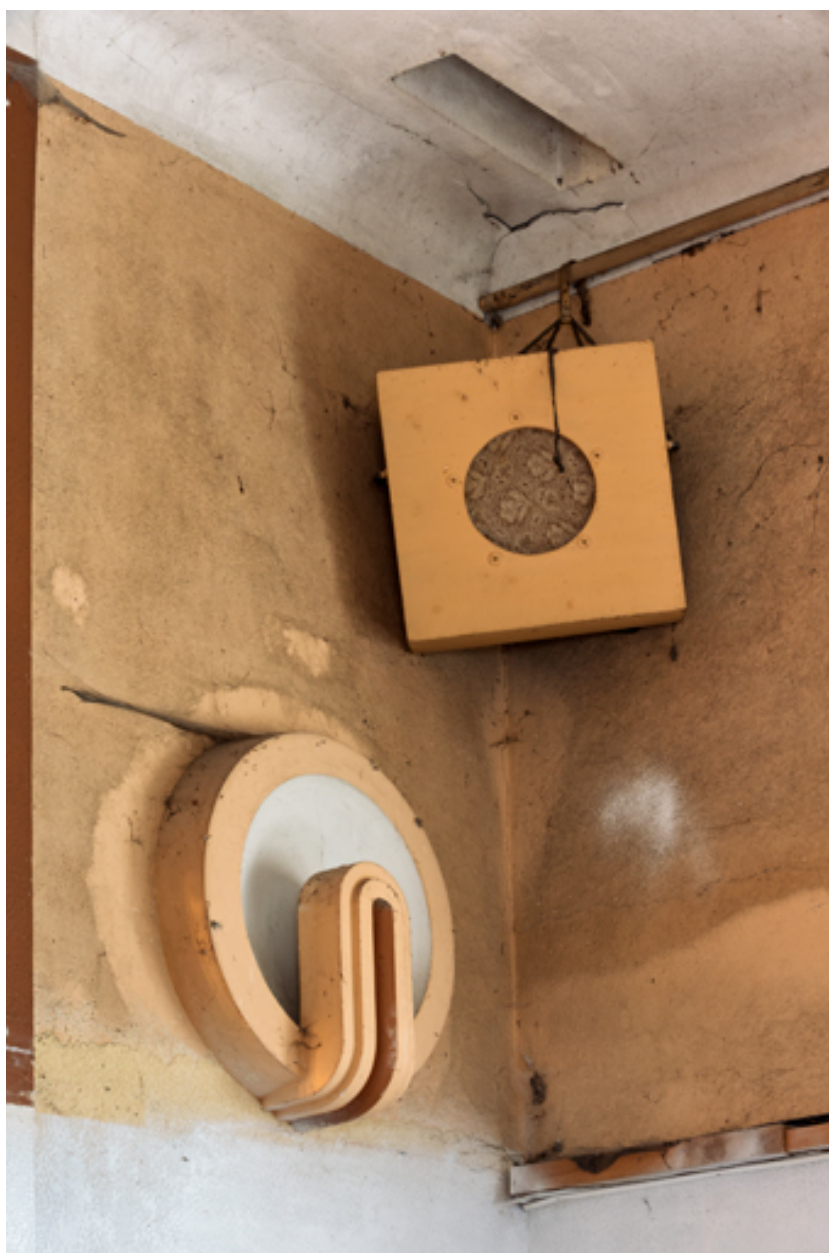
Luminaire d'applique et haut-parleur.
