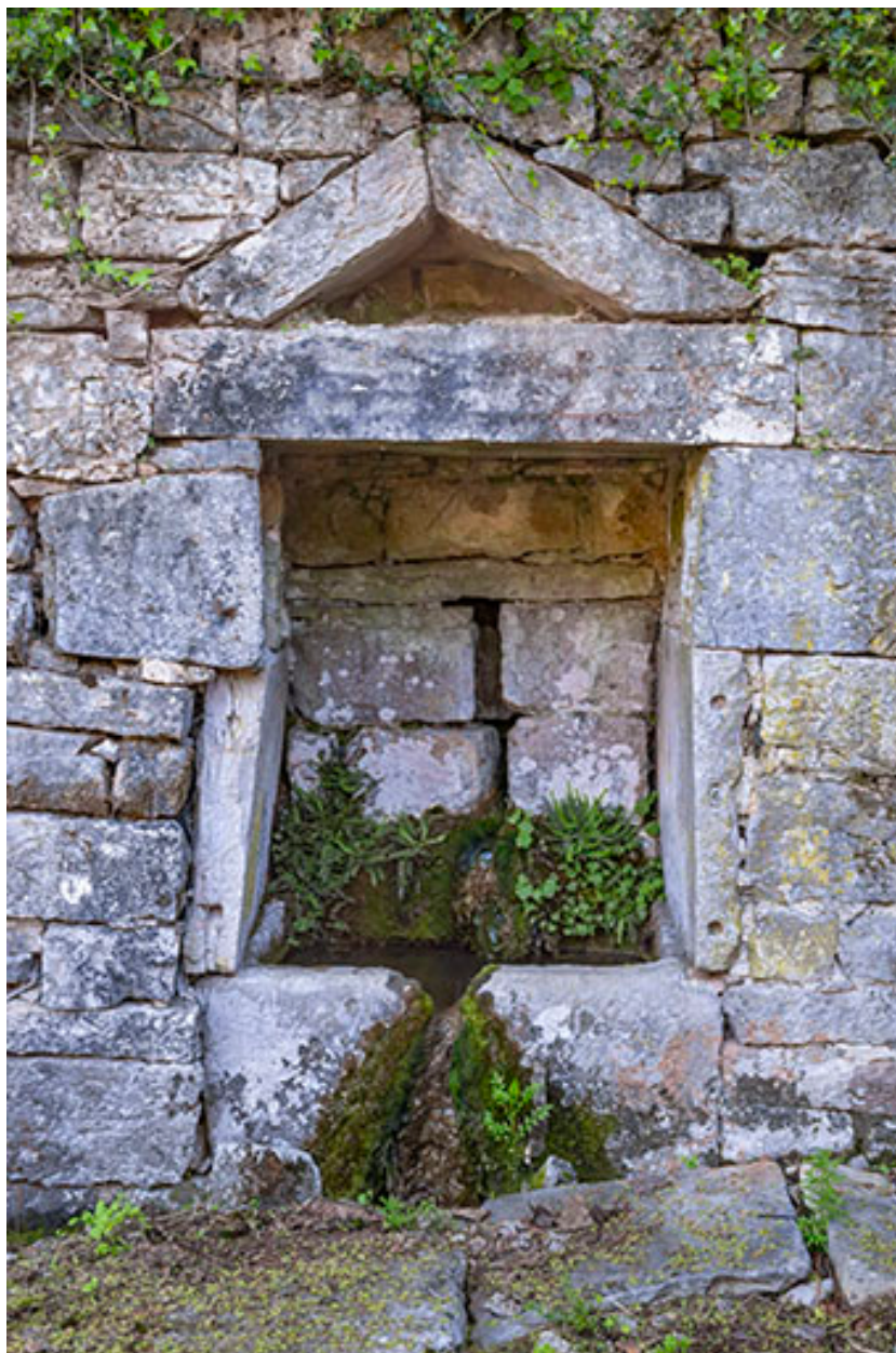
Niche (captage de source) dans le jardin.
