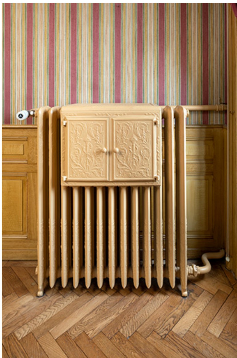
Maison, salon : radiateur avec chauffe-plat.
