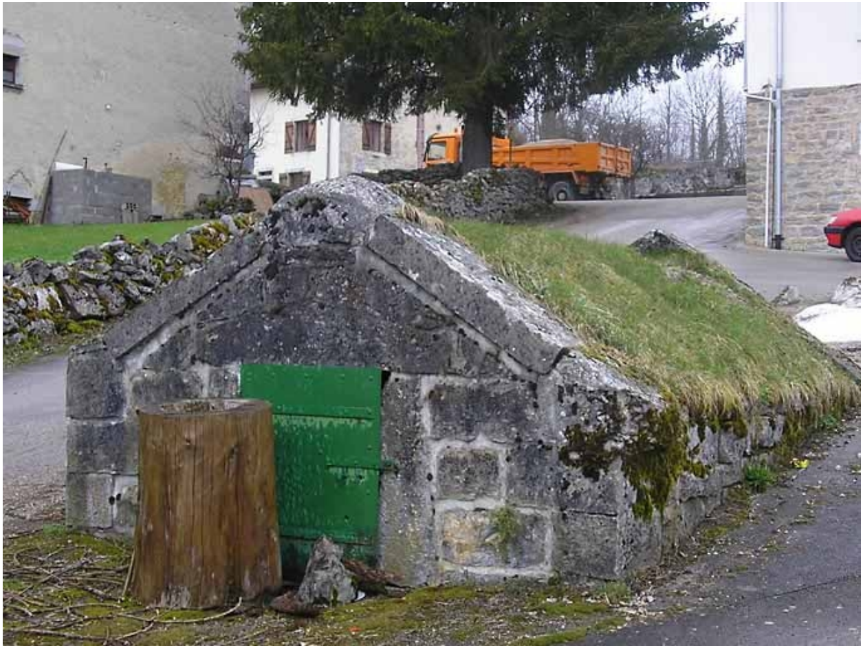
Vue de trois quarts sur ensemble hydraulique.
