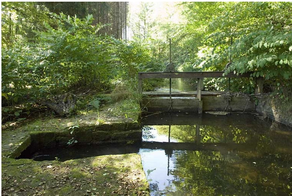
Vannage sur le bief de dérivation.
