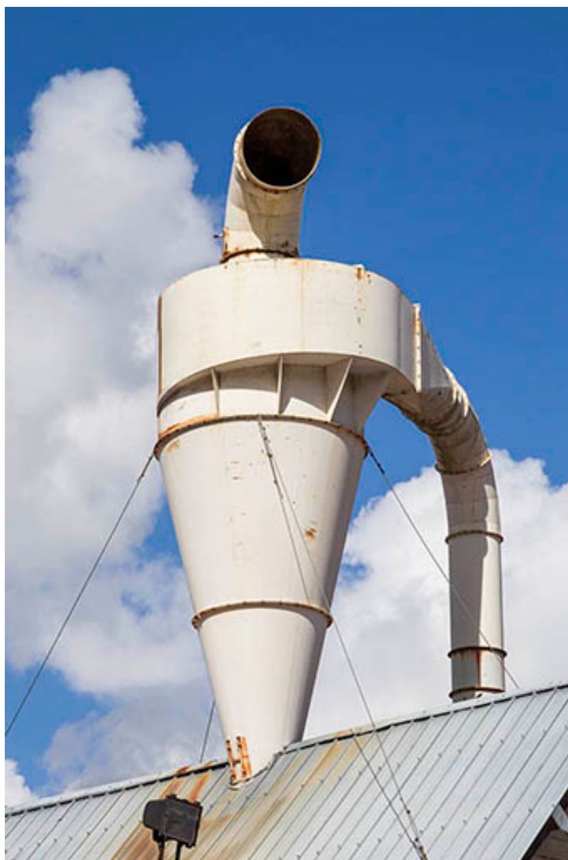
Silo à sciure (L) : cyclone.
