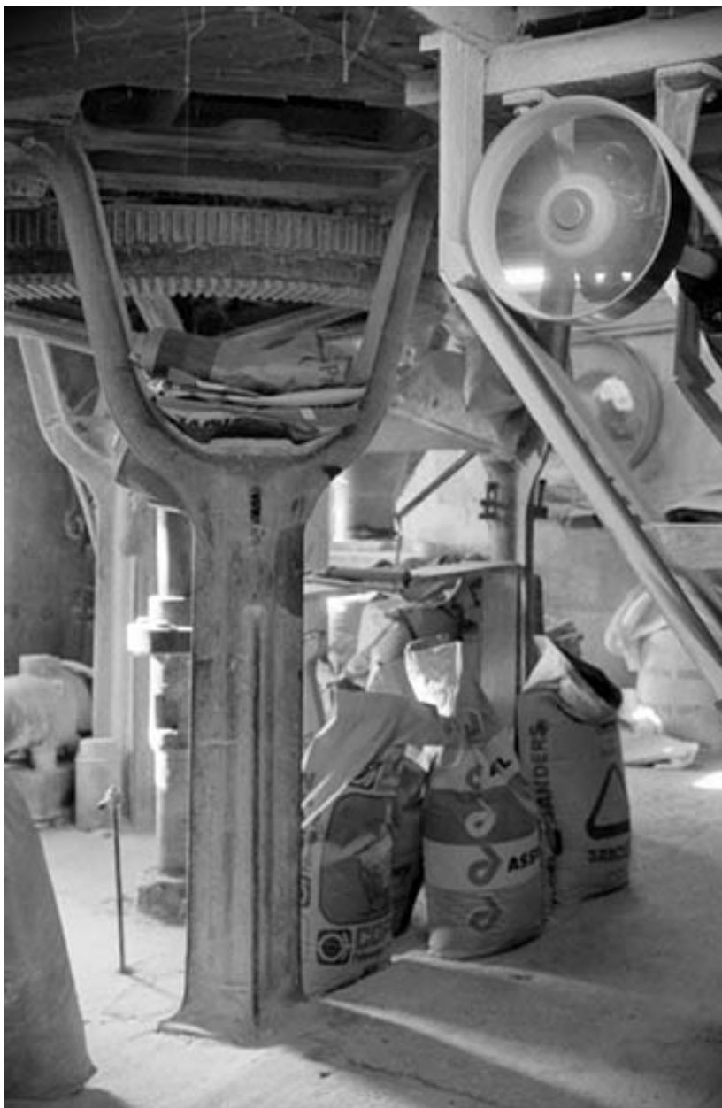
Transmission et support de meules (beffroi).
