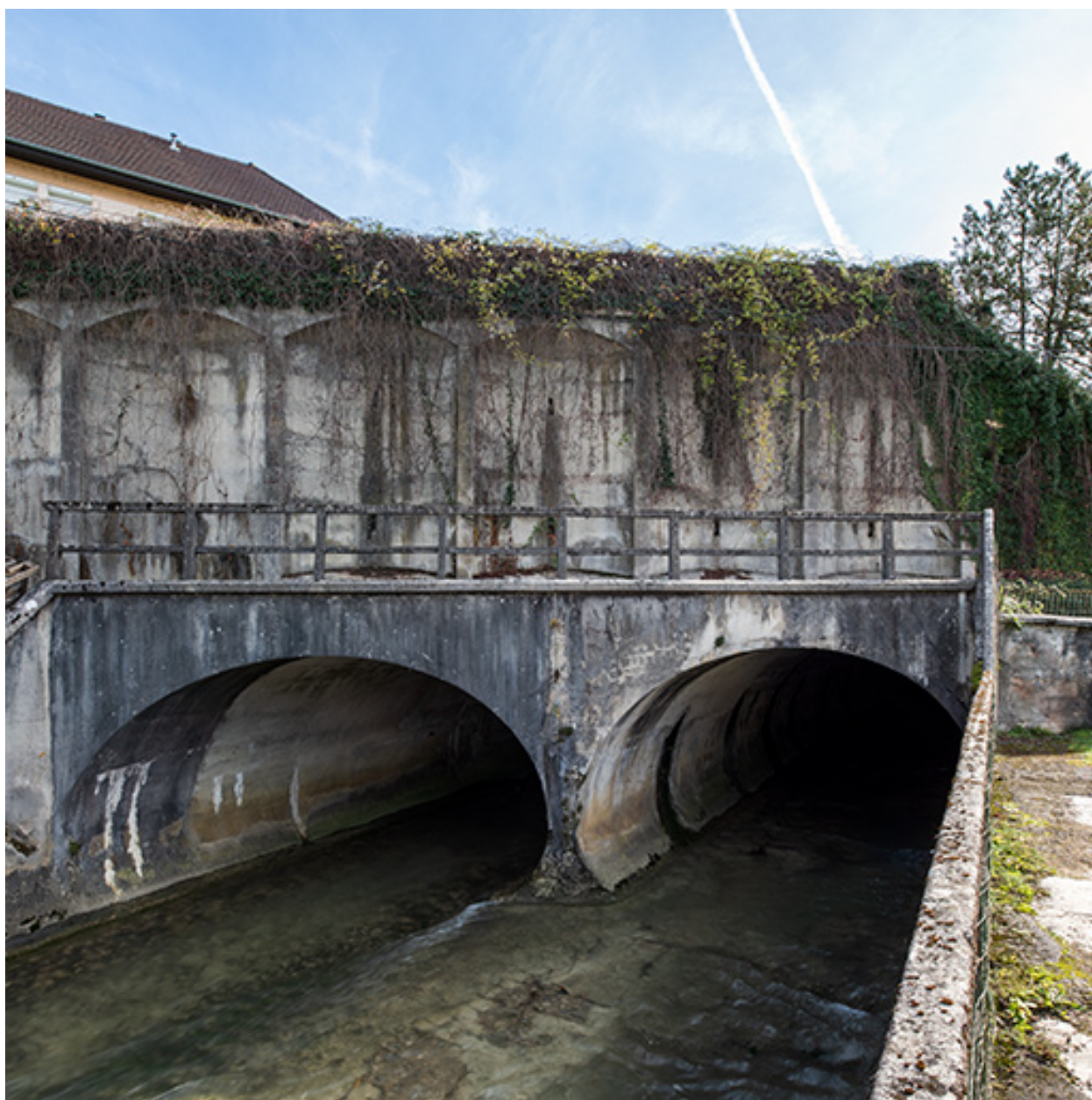
Canalisations de sortie.
