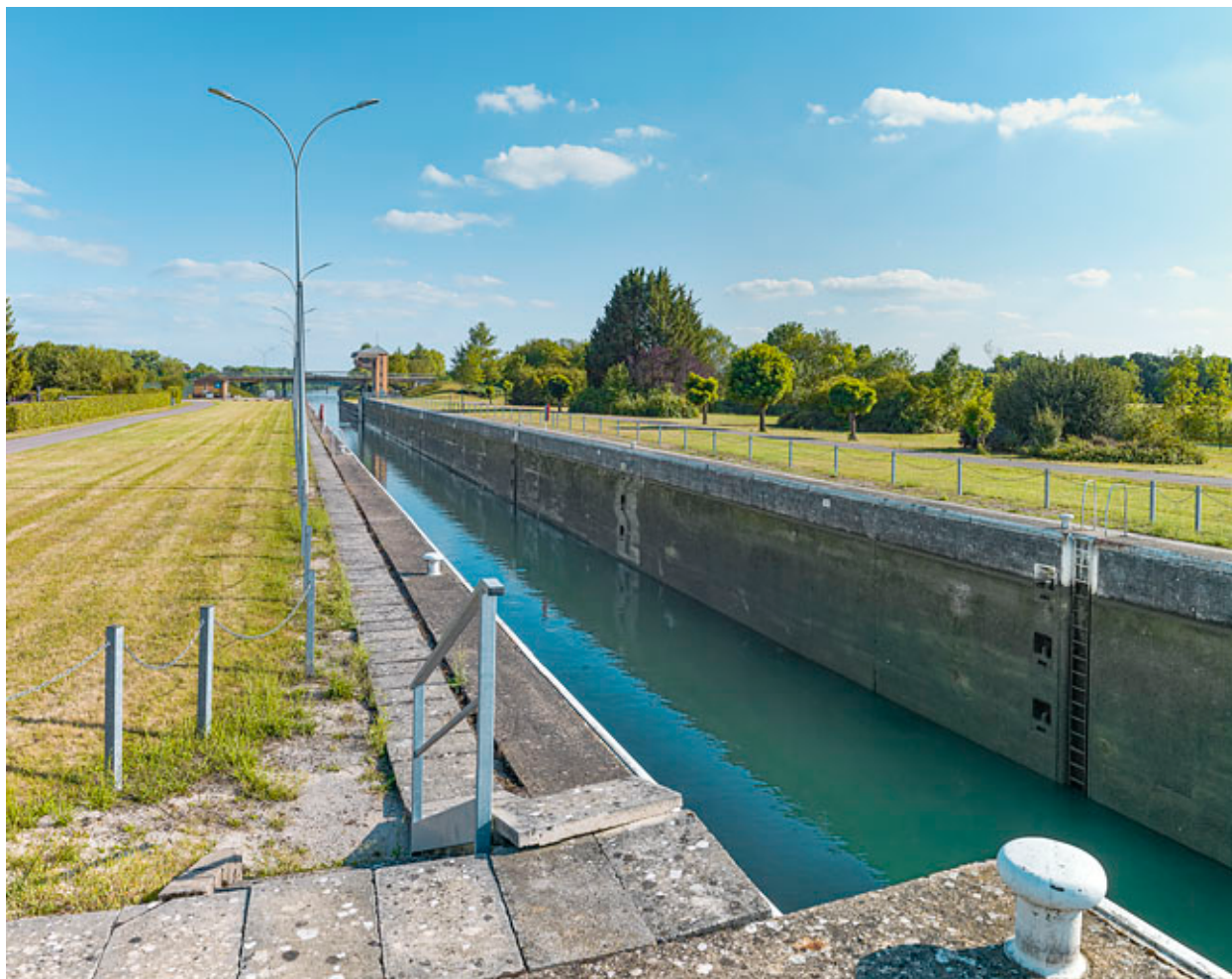
Vue d'ensemble du sas.
