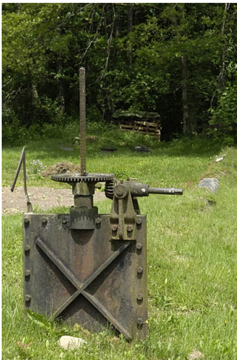
Vannage de la conduite forcée.
