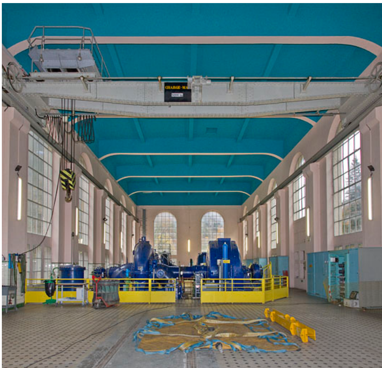
Centrale : intérieur de la salle des machines.
