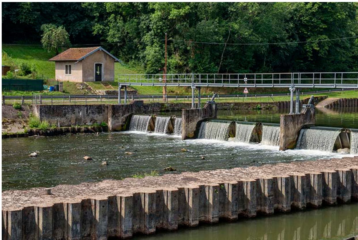
Le barrage mobile.
