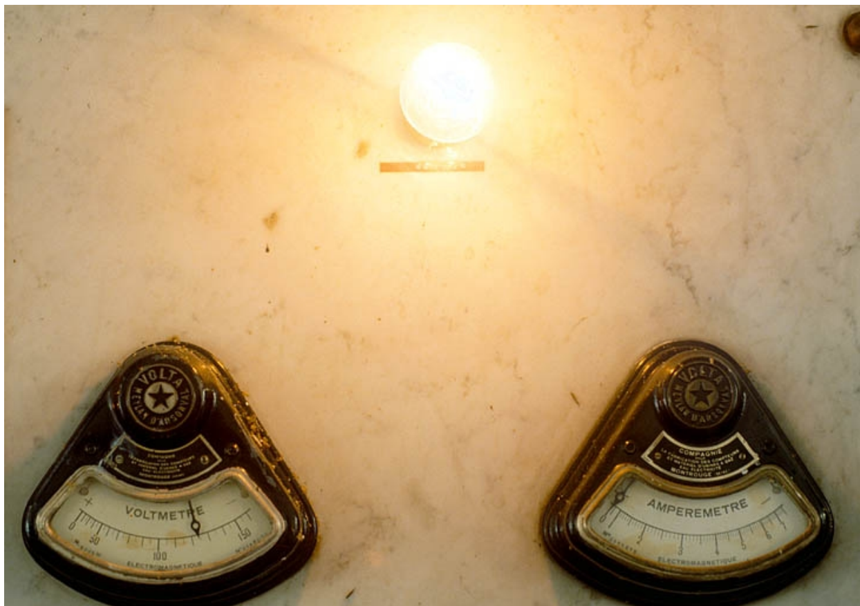
Détail du tableau de contrôle.
