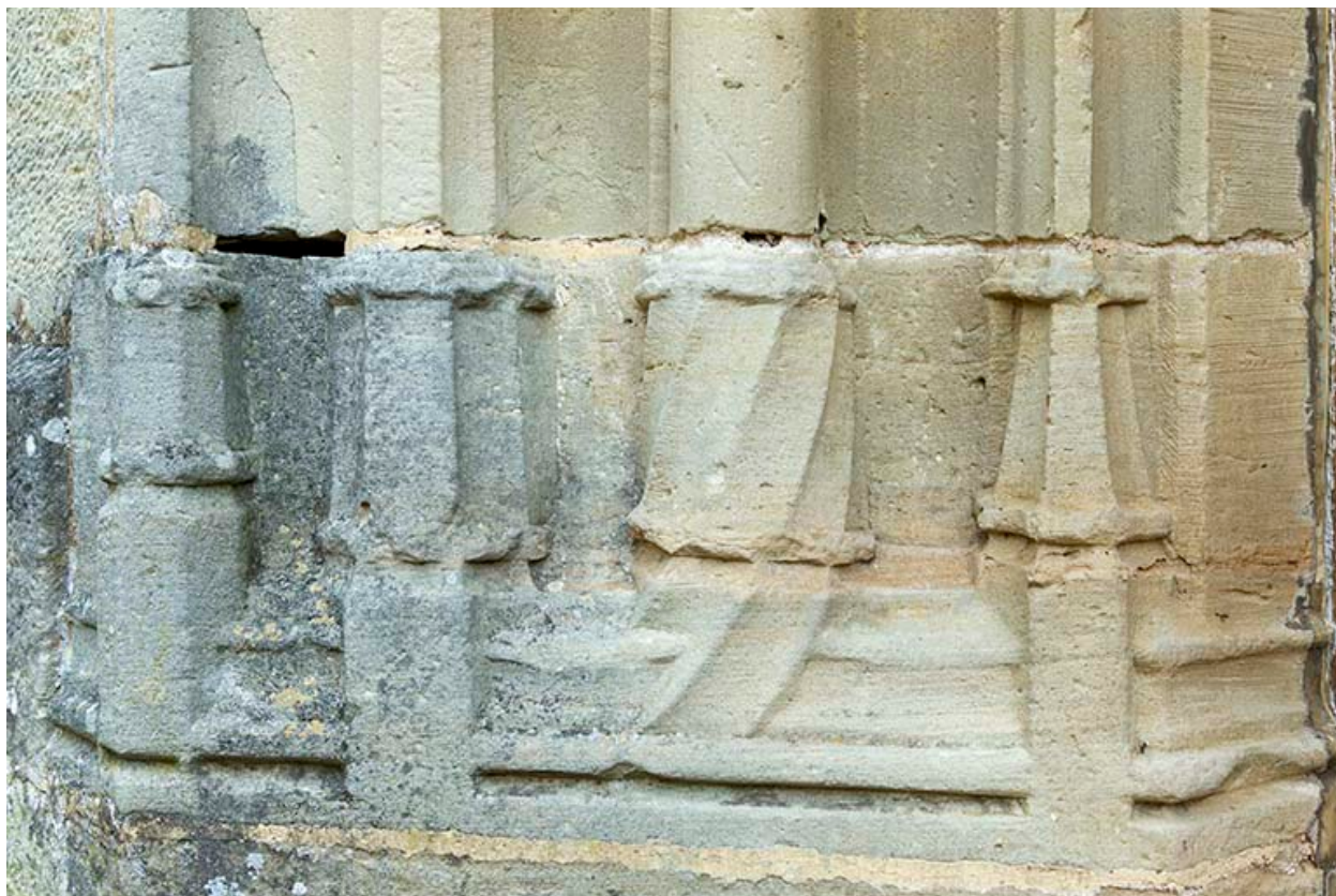
Détail de la base du piédroit gauche.
