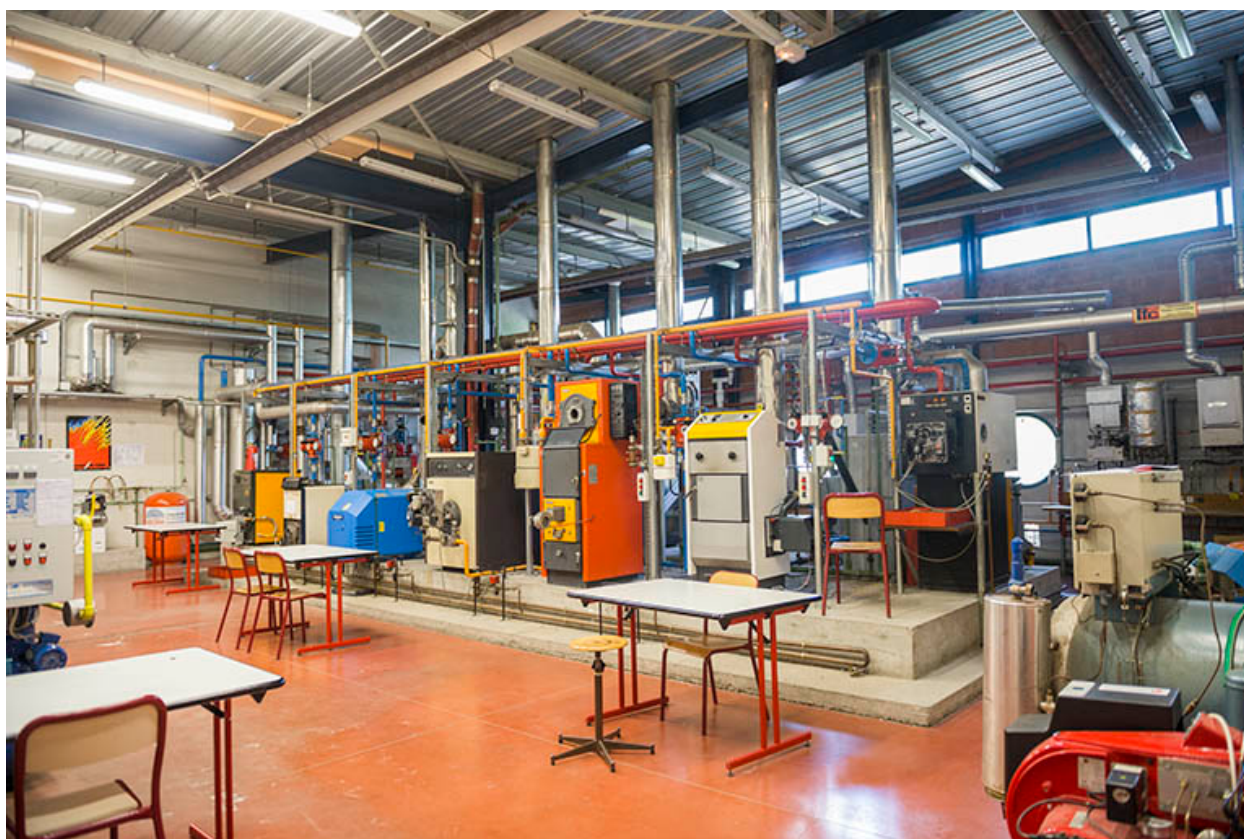
Vue intérieure des ateliers du pôle énergie.
