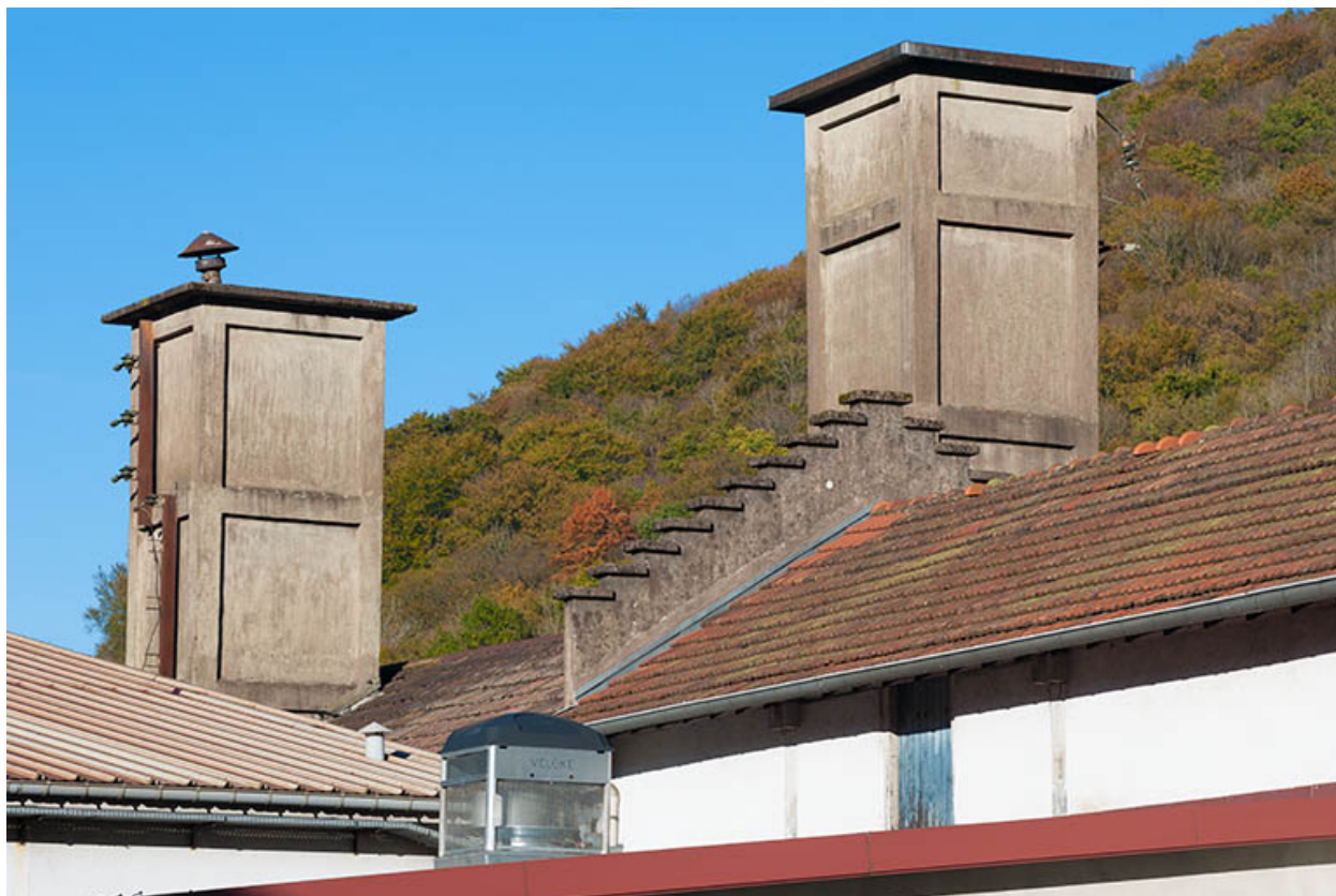
Anciens transformateurs électriques.
