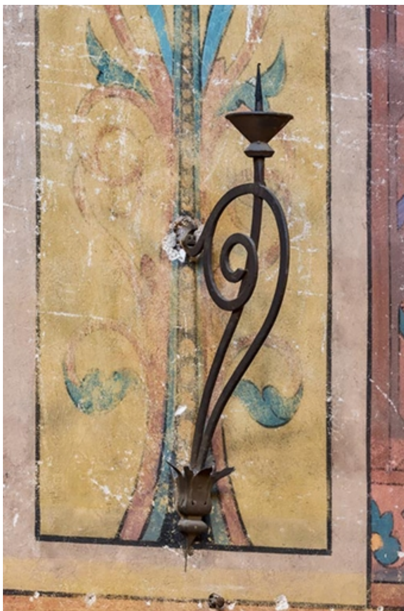
Nef, mur nord (2022) : luminaire d'applique.
